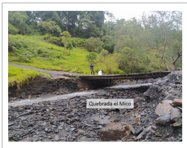
Figura 1. Depósitos de clastos y daño por socavación sobre la Quebrada El Mico.
