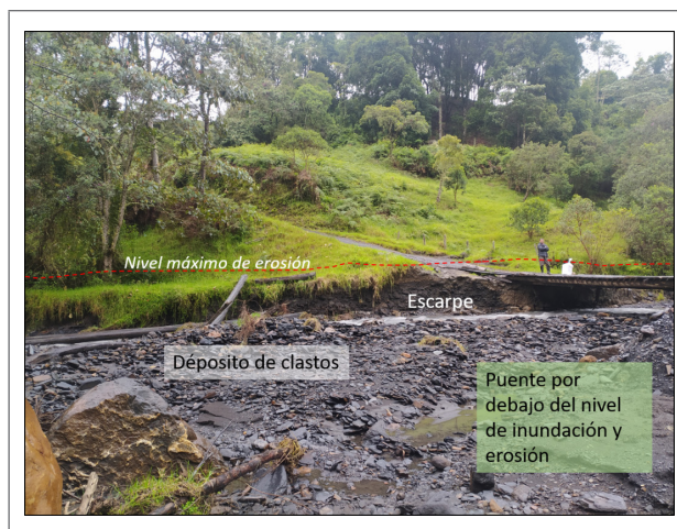
Figura 10. Afectaciones en los puentes y laderas. Fuente: elaboración propia.
